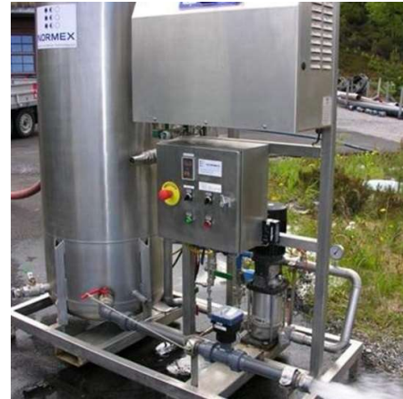
Figur 80. Ozonberiget vand generator – Optimar
